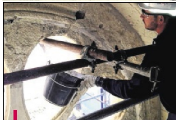
Les travaux de restauration du chevet de l'abbatiale ont pris une dizaine de jours.
